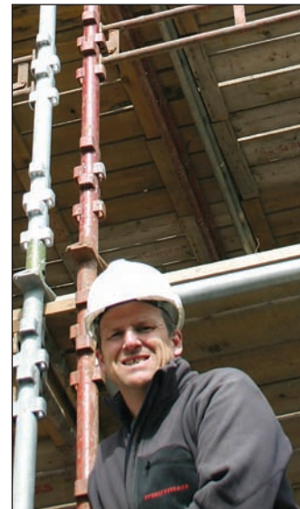
ANALYSE. - Ved demontering av stillas gjøres alltid en jobb- sikkerhetsanalyse før vi starter, der vi går gjennom arbeidet med stillasmontørene, sier Trond Thorstensen
